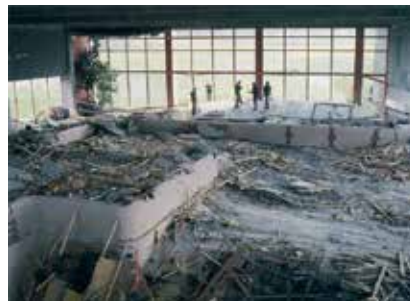
1985 u Švicarskom mjestu Usteru u jednom zatvorenom bazenu došlo je do pada obješenog betonskog stropa (deke). Ovjesi deke od nehrđajućeg A2 čelika nisu pokazivali prema vani nikakav nedostatak , dok su unutra bili djelomično ili potpuno razoreni naponskom korozijom.
